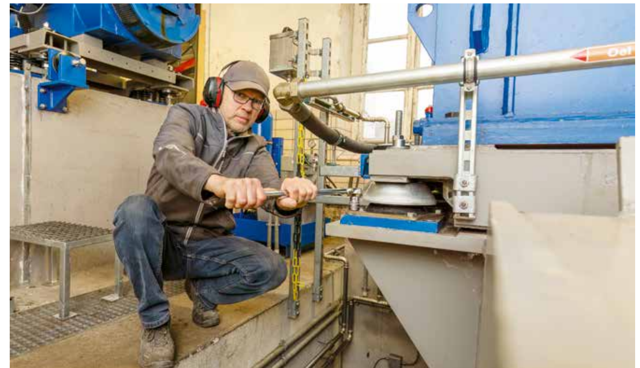
Hans-Friedrich Nölke von den Stadtwerken betreut die laufenden Arbeiten an der Turbine.
